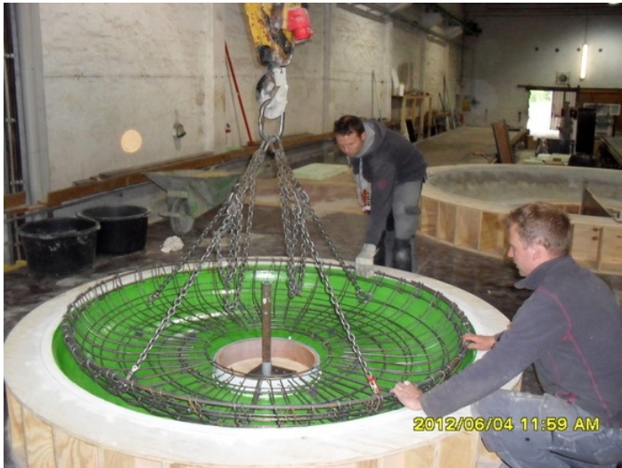
Abb. 21 und 22: Der Formbau und das eingeschaltete Unterteil für den Nachbau des Kaskadenbrunnens im Forster Rosengarten.
